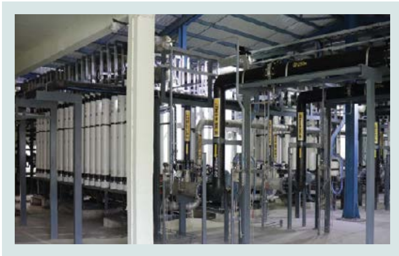
30 MLD Town Sewage TTP
